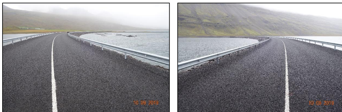
Mynd 3.2 a) og b) Myndir teknar á nýbyggingu á vegi 1-tx stöð vantar
