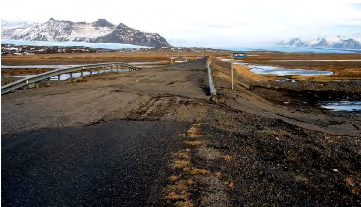
Mynd 1. Skemmd á malbiki á hringveginum, rétt sunnan við Kvísker, horft til norðurs. Í forgrunni er malbikið fokið af veginum og liggur til hægri við hann, í því sem næst heilu lagi. Ljósmynd: Sigurður Gunnarsson, Hnappavöllum.
