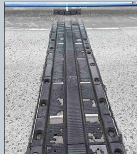
Dæmi um hefðbundna mekaníska þenslufúgu, mynd tekin á Borgarfjarðarbrú.
