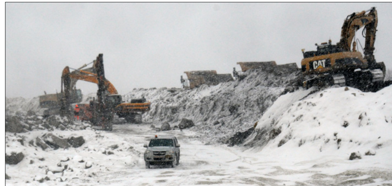
Framkvæmdir við Arnarnesveg 3. febrúar 2016. Verktaki er Suðurverk ehf. og Loftorka Reykjavík ehf. Ljósmynd: G. Pétur Matthíasson.
