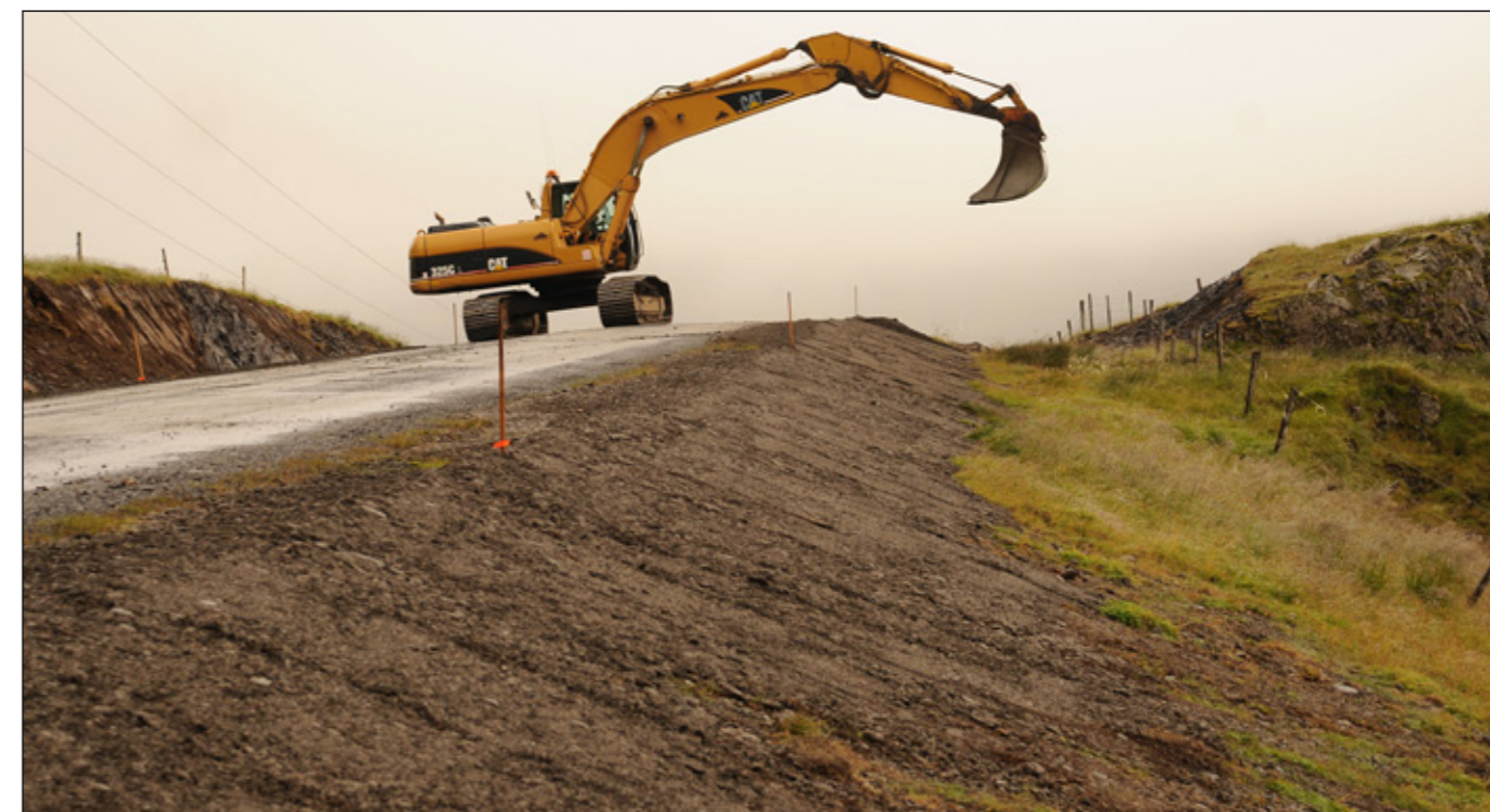
Hringvegur (1) í Lóni við Svínhóla. Endurbætur á vegsvæði þann 20.08.2015 fyrir fræsingu, styrkingu og yfirlögn á um 1,5 km kafla sem unnið er að nú seinnihlutann í september 2015.
