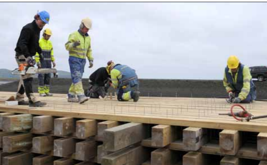
Gerð bráðabirgðabrúar á Múlakvísl 12. júlí 2011. Brúardekkið var smíðað í einingum á landi og þær síðan hífðar á stálbitana.
