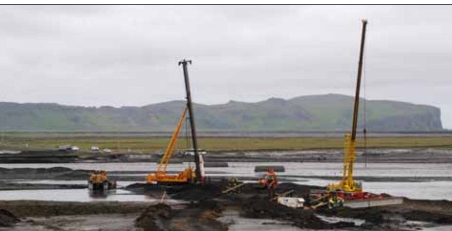
Múlakvísl 12. júlí 2011. Til vinstri á myndinni er hamarinn sem rak niður staura fyrir undirstöður. Til hægri er krani brúarvinnuflokkanna.
