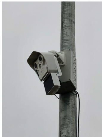
Mynd 3: Greiningarbúnaður festur á ljósastaur. Staðsetning - Snið 8a.
