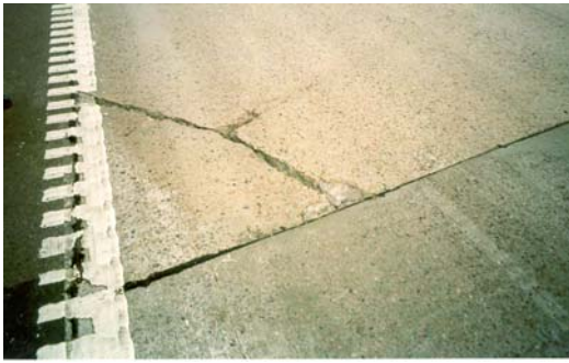
Mynd 5.3: Hornsprunga í steyptu slitlagi.
