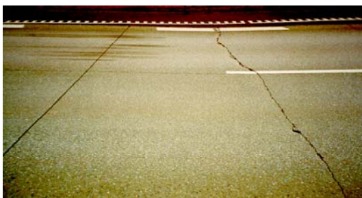
Mynd 5.2: Þversprungu í steyptu slitlagi.
