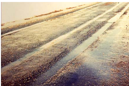
Mynd 4.2: Hjólför vegna sigs. [Ljós: Statens vegvesen, 1996]
