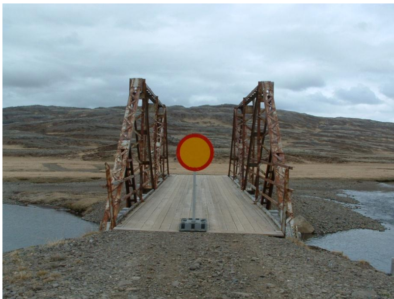
Mynd 33. Aflögð brú á Beilá. Ljósmynd: Valgeir Ingólfsson.
