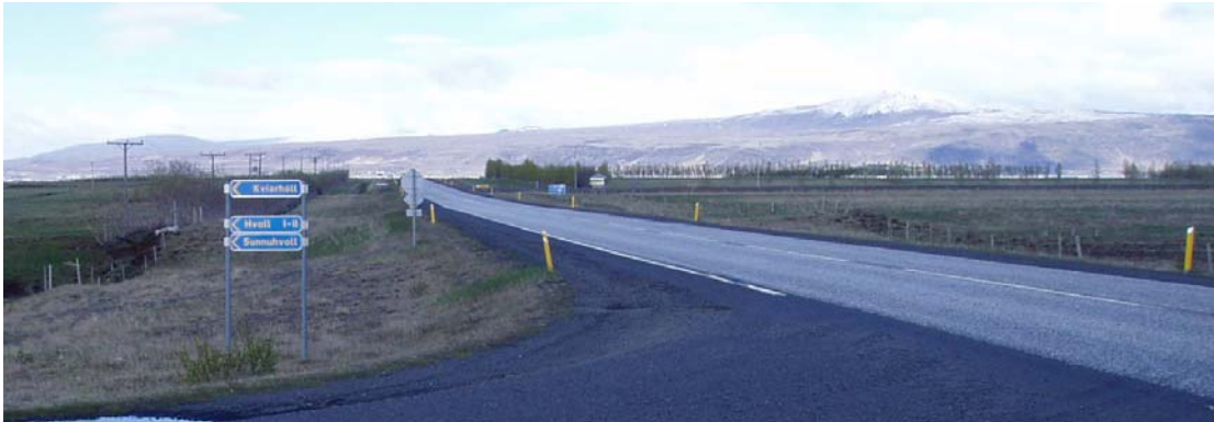
Mynd 2-7 Horft vestur að Hvammsvegi eystri (374) frá afleggjara við Hvalsveg (3760). Mislæg vegamót verða hér reist með veltengingum sunnan vegar.
