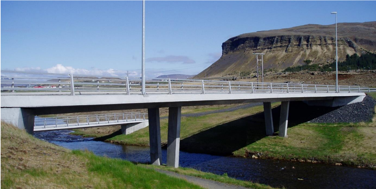
MYND 7 Brýr á Korpúlstaðavegi og göngubrú milli Reykjavíkur og Mosfellsbæjar. Eftirspenntar brýr byggðar 2005.
