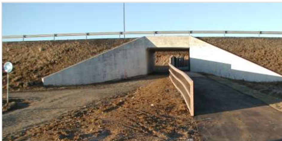
Mynd 6-15 Steypt göng undir Breiðhóltsbraut. Heildarbreidd ganga er 5 m, hér hefur verið settur upp veggur til að skilja að umferð ríðandi manna frá annarri umferð, breidd reiðstígs er 3 m og lofthæðin er einnig 3 m.
