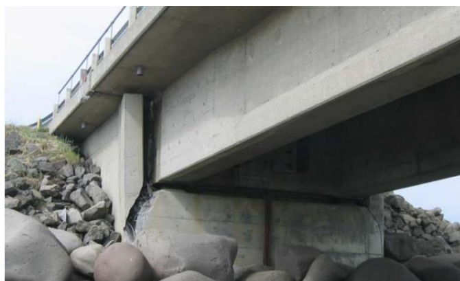
Mynd 1: Skemmdir á landstöpli Óseyrarbrúar (Jónsson 2009).
