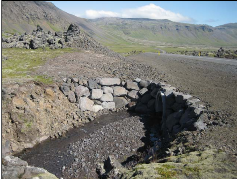
Mynd 60. Fyrirmyndarfrágangur á ræsi við stöð 14.860. Hraunhóllinn við stöð 14.800 í baksýn. Sennilega vantar hér þó vegrið (H.A., 2007).
