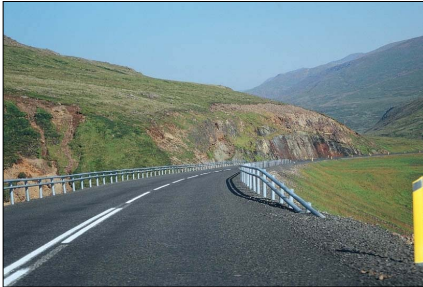
Mynd 66. Vestfjarðarvegur um Bröttubrekku. Talsverð hætta á landrofi við skeringarbrún (Ljósmynd: Viktor Arnar Ingólfsson).
