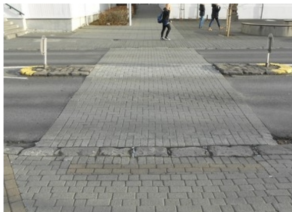
Mynd 23. Gönguþverun yfir Fríkirkjuveg þar sem bæði gangstétt og gönguþverun er hellulögð á svipaðan hátt sem mögulega veldur misskilningi vegfarenda.
