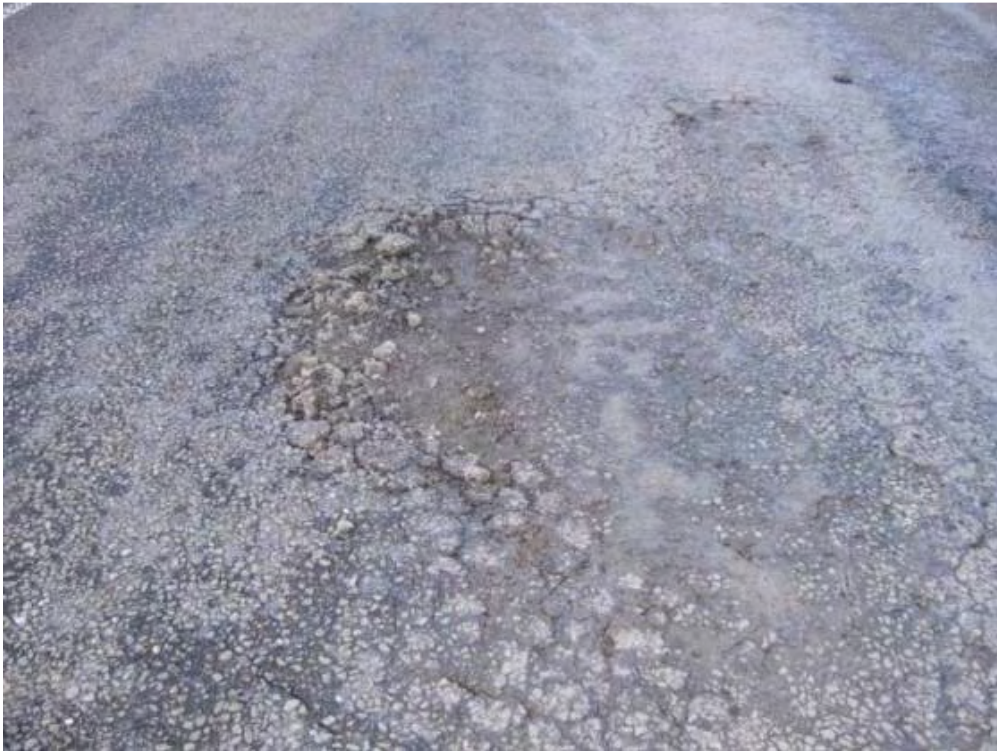
Mynd 5.1.2. Dæmi um skemmdir í vegi úr sprengdu bergi.
